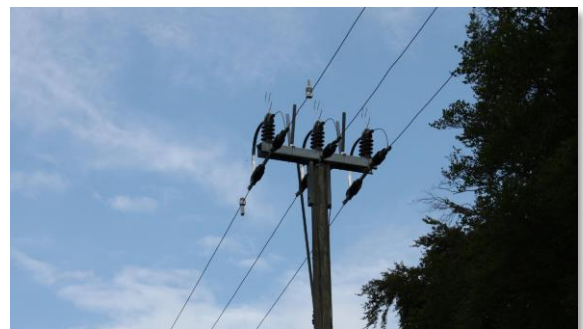
Foto dei test in media tensione
